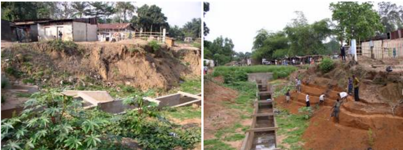
El inicio de una cárcava tratada en la ciudad. La foto de la derecha muestra la cabecera ya estabilizada con vetiver y las pendientes preparadas para la plantación.
